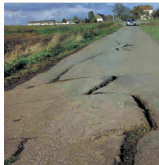
Setzungsschäden an einem landwirtschaftlichen Weg
